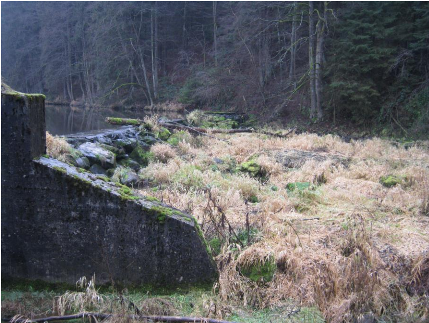
Foto 9: Wehranlage Jedesbachermühle, ohne Fischwanderhilfe, ohne Abgabe einer Restwassermenge
